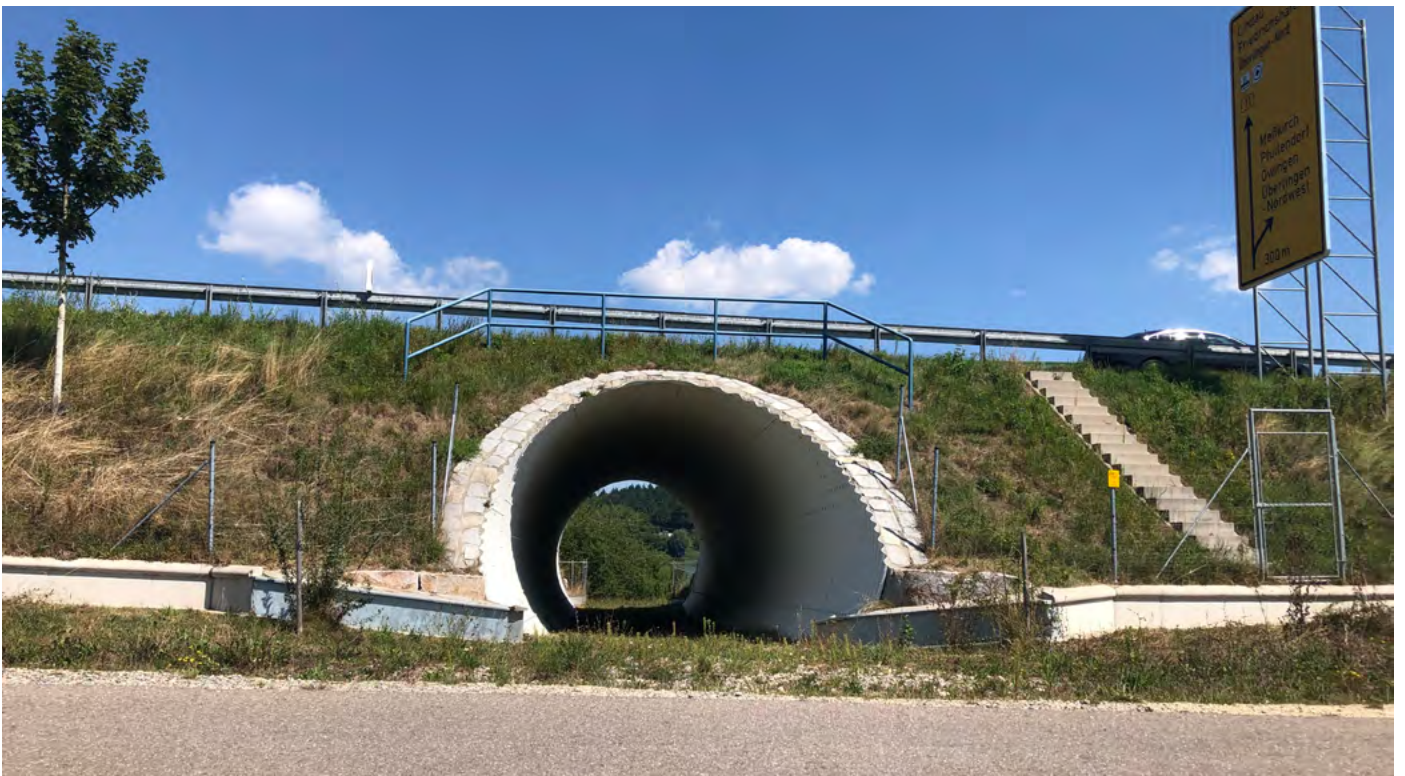
Abbildung 14: Blick auf die Faunaunterführung Überlingen von Westen. Auf der Südwest-Seite des Bauwerks verläuft parallel zur Bundesstraße ein asphaltierter Wirtschaftsweg und trennt die Faunaunterführung von den angrenzenden Agrarflächen und dem Feuchtbiotop. Datum der Aufnahme: 15.10.2021.
